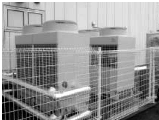
新設空冷HPチラー
