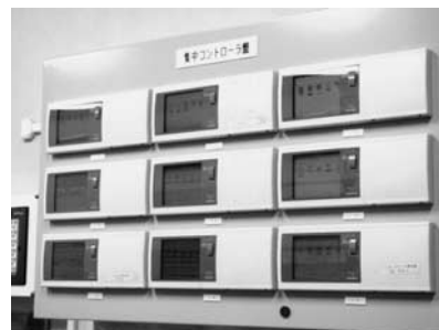
集中コントローラ盤(空調)
