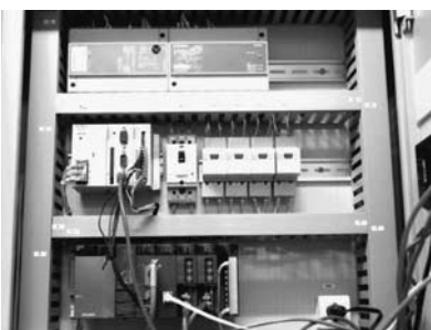
集中コントローラ盤(電力・照明)
