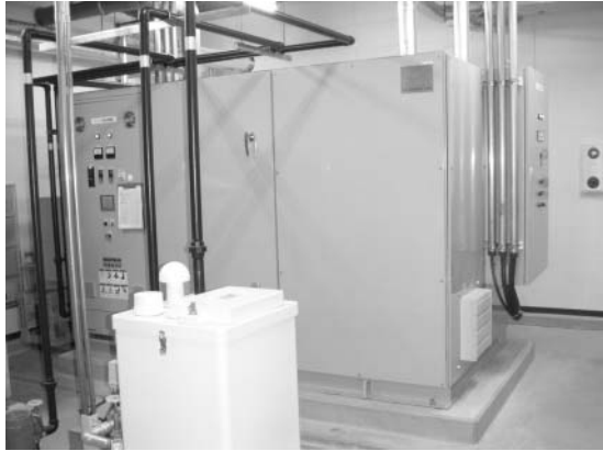
写真2 CO 2 /NH 3 ユニット外観（機械室）
