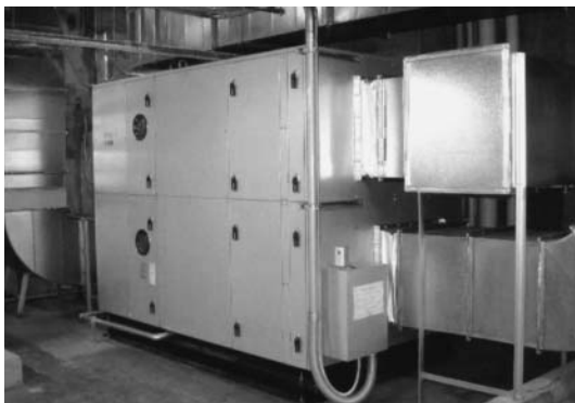
図6 熱回収ヒートポンプ外調機
