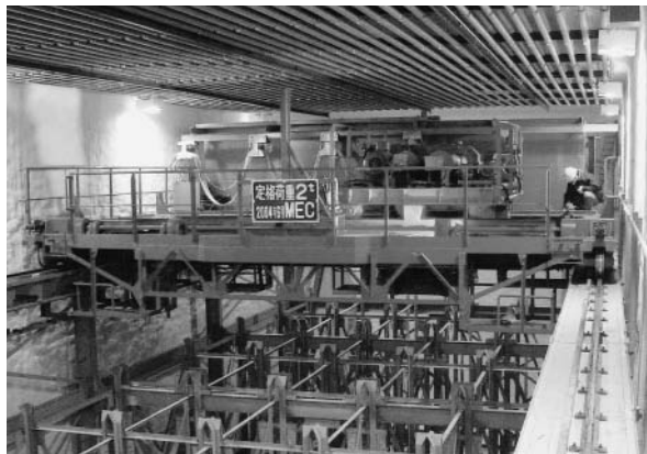
図1 天井コイルと自動クレーン
