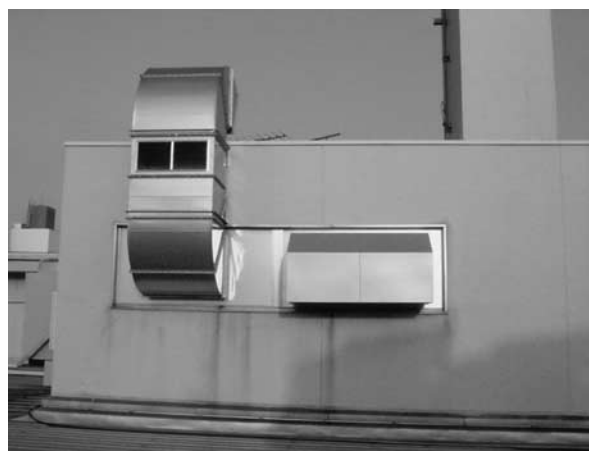
〈外部 新設ダクト〉左：排気ダクト 右：外気ダクト
