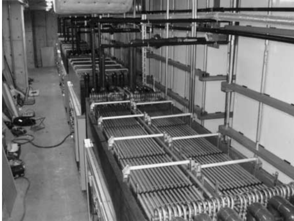
ヒートポンプ給湯ユニットが5台並んで上部の蒸発器が見えている。この熱交換器で浄化槽の温排水から熱を採る。
