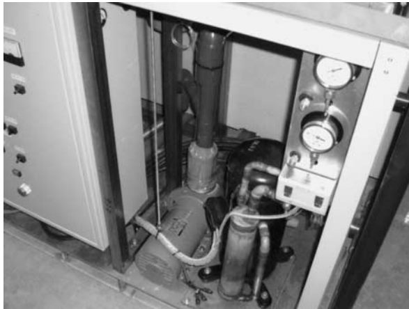
ヒートポンプ給湯器ユニットの右端に高温段圧縮器と給湯加圧ポンプが設置されている。左側に制御盤の一部が見える。
